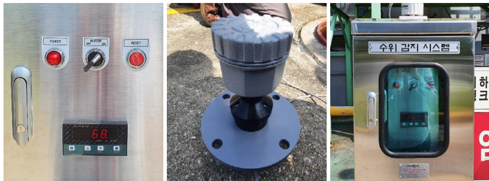
톨루엔 저장탱크 초음파 액위계 및 과충전 방지용 경보장치
